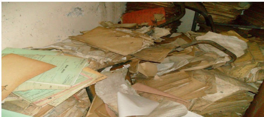
Figure 5. Dossiers d'archives endommagés par les eaux de pluie passant par les trous et les fenêtres d'aération de la cave de l'immeuble abritant la Cour suprême du Burundi.
